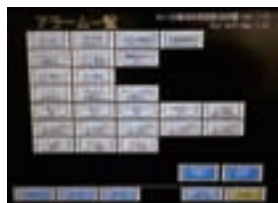
制御画面 (ALARM)
